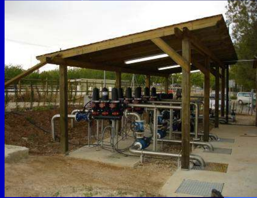
Recinto de bombeo
