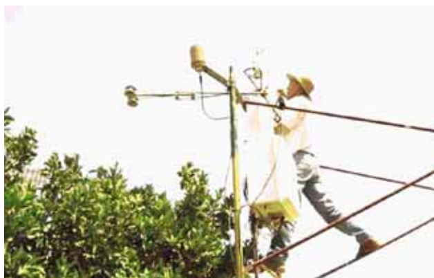
Vista 5. Instalación de los equipos de medida en la finca A (naranjos adultos).
